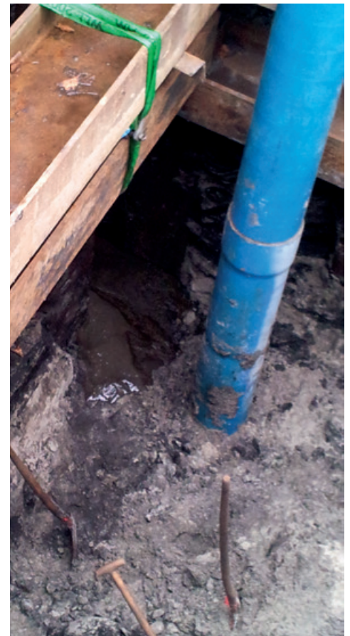
Abb. 8 – Wassereintritt in Baugrube 1 während des Probetriebs
